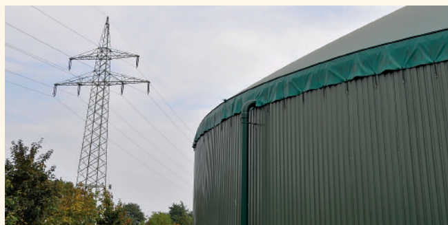
Für die Energiewende ist Strom aus Biogasanlagen unverzichtbar.
